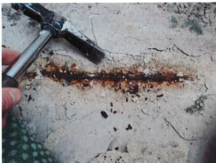
Foto nr. 19: G 5. Opphugning i utsprengningen på forrige foto viser korrodert armering.
